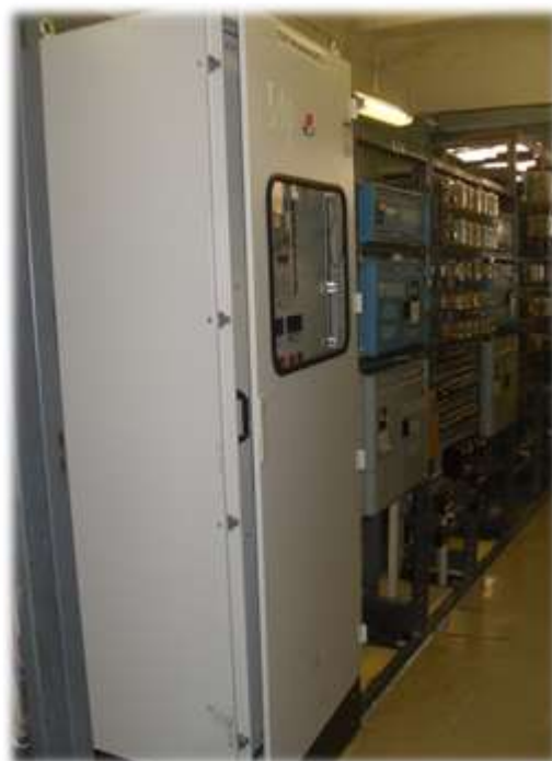
Рисунок 8.1.6. Дугогасящие реакторы, шкаф управления дугогасящими реакторами на ПС 220 кВ Южная
