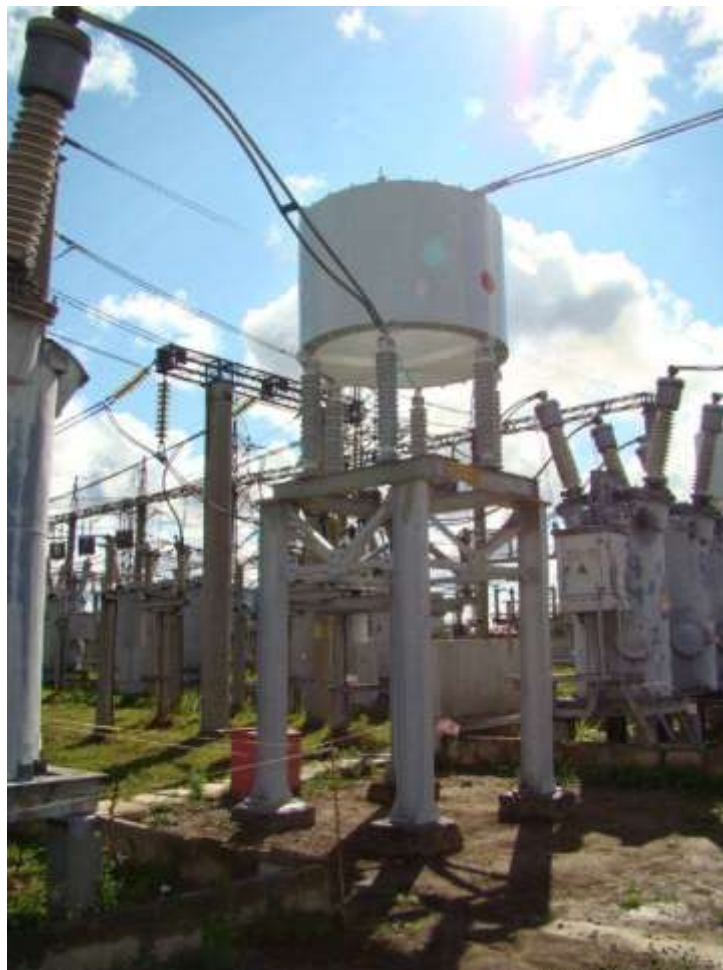
Рис. 8.1.6. ПС «Восточная». Фаза токоограничивающего реактора 110 кВ
