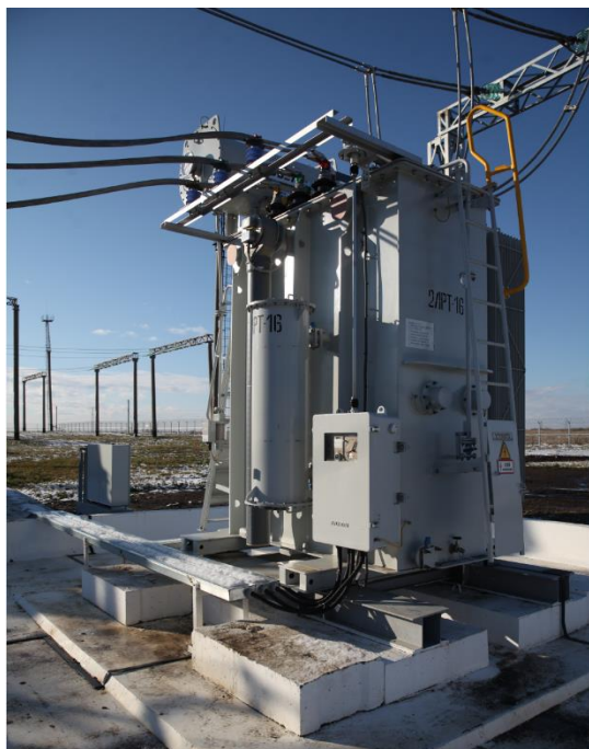
Рисунок 8.1.9. Установка 2ЛРТ-16 на ПС 220 кВ Дружная
